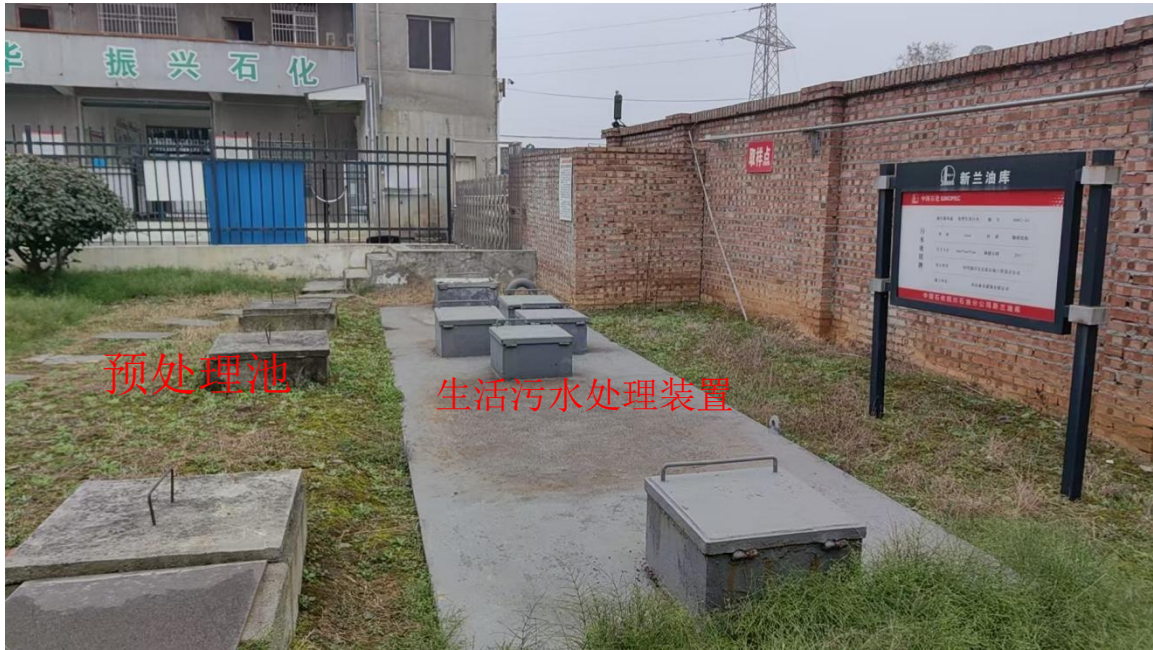
图 2-11 预处理池和地埋式生活污水处理装置
