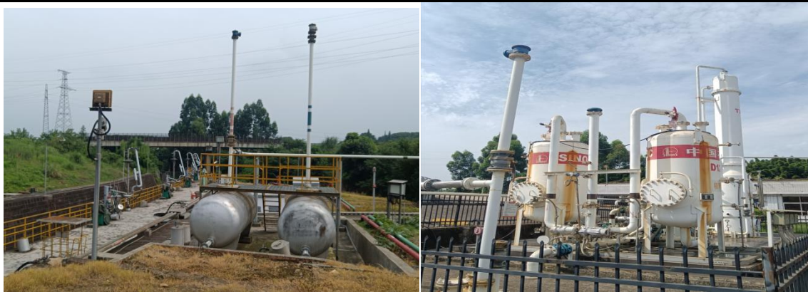
图 2-13 扫仓罐油气收集管道（左）和“吸附+吸收”油气处理设施（右）
