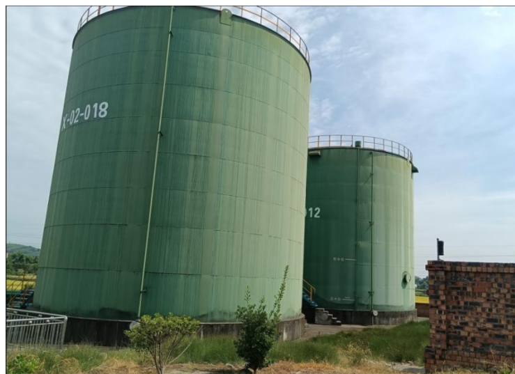
图 2-23 消防水罐照片
